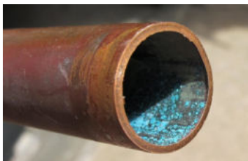
Зураг 3.3.7. Зэс хоолой коррозод орсон байдал
